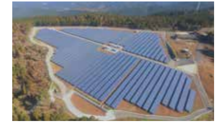
芦北発電所(熊本県芦北郡) 2.3 MW 2015年
