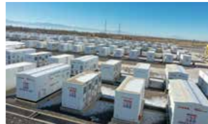
中国 150 MW/300 MWh 2023年
