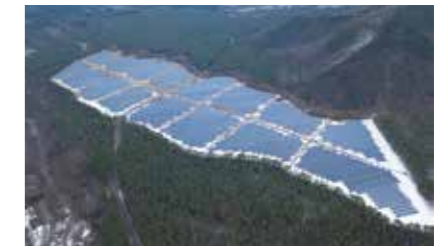
鳥取県西伯郡 27.3 MW 2017年
