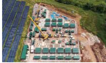
イギリス 61 MW/122 MWh 2025年
