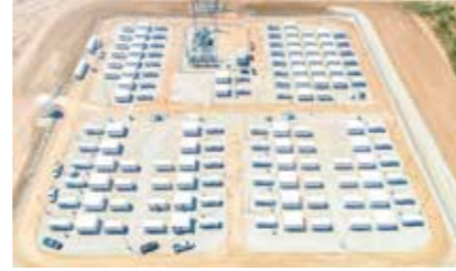
アメリカ 196 MW/392 MWh 2024年
