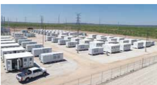
アメリカ 100 MW/498 MWh 2024年
