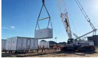
アメリカ 300 MW/1,433 GWh 2025年
