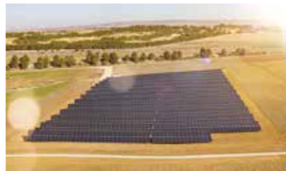
スペイン 1 MW 2022年
