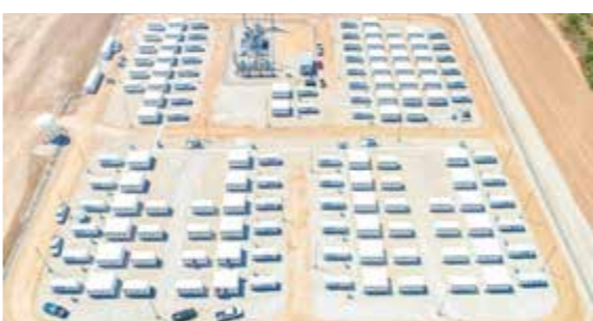
アメリカ 196 MW/392 MWh 2024年
