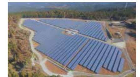
熊本県葦北郡 2.3 MW 2015年
