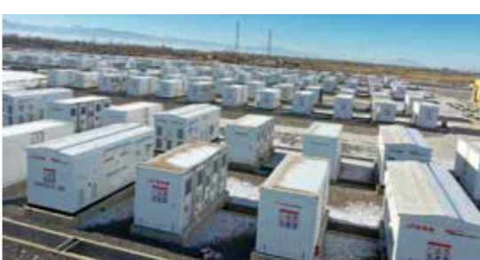
中国 150 MW/300 MWh 2023年
