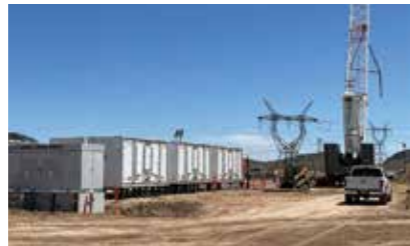
アメリカ 362 MW/543 MWh 2024年
