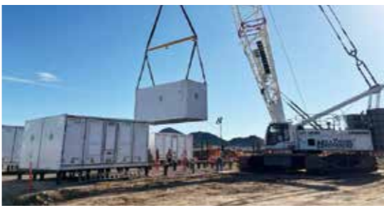
アメリカ 300 MW/1,433 GWh 2025年
