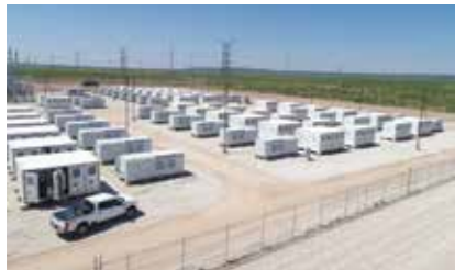
アメリカ 100 MW/498 MWh 2024年
