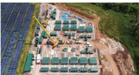
イギリス 61 MW/122 MWh 2025年
