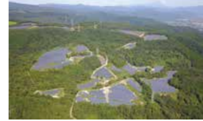
福島県福島市 100 MW 2022年
